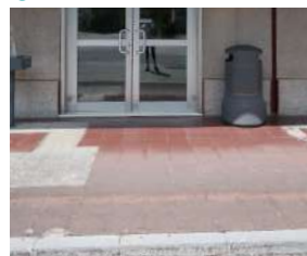
Mancata accessibilità strada-edificio stazione
