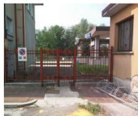
Assenza accessibilità strada-banchina 1
