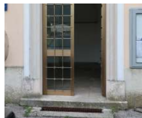
Assenza accessibilità strada-edificio stazione
