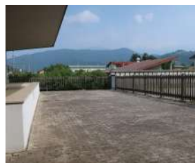
Mancata accessibilità strada-banchina 1
