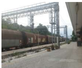
Assenza di adeguamento delle banchine della stazione
