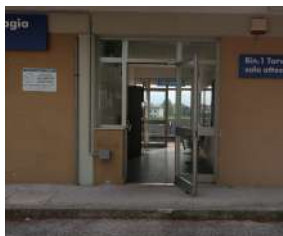
Mancata accessibilità strada-edificio stazione
