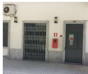
Mancanza accessibilità edificio
