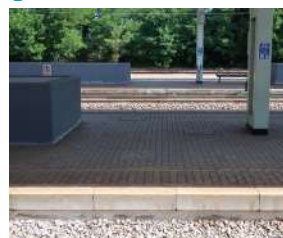
Mancato adeguamento banchine
