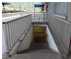
Assenza scivoli in sottopasso
