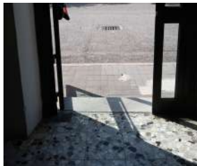
Mancata accessibilità edificio strada - stazione
