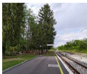
Mancato adeguamento banchine
