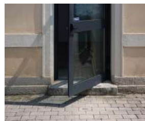
Assenza accessibilità strada-edificio stazione
