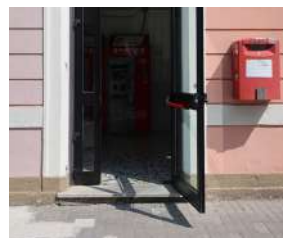
Mancata accessibilità edificio strada - stazione
