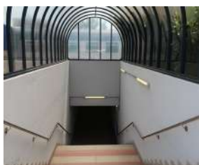
Assenza adeguata accessibilità tra banchina 1-altre banchine
