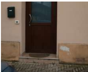
Mancata accessibilità strada-edificio stazione
