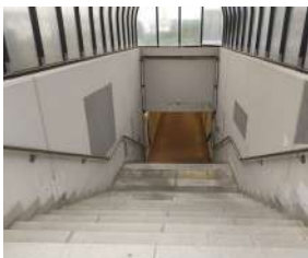
Assenza scivolo in sottopasso
