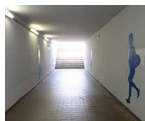
Assenza di rampe/scivoli in sottopasso
