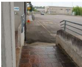
Presenza rampa strada-banchina
