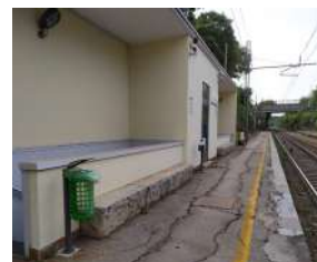
Mancanza adeguamento banchine
