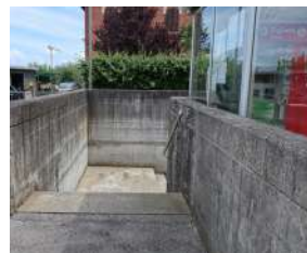
Presenza sottopassaggio non accessibile tra le banchine
