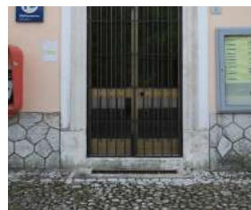
Assenza accessibilità strada-edificio stazione-banchina n.1
