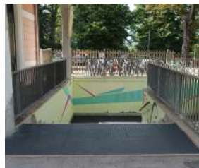
Assenza sistemi che garantiscano l'accessibilità tra le banchine
